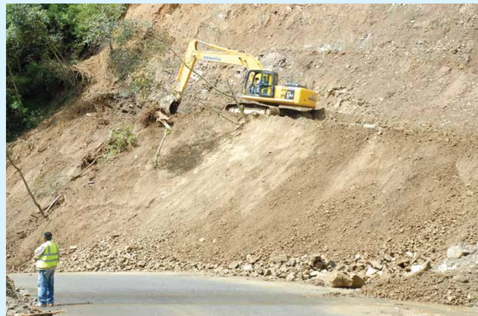
Las fuertes lluvias que cada año se producen provocan, entre otros efectos, deslizamientos e inundaciones, con importantes daños en las vías principales del país (foto archivo ODI).
